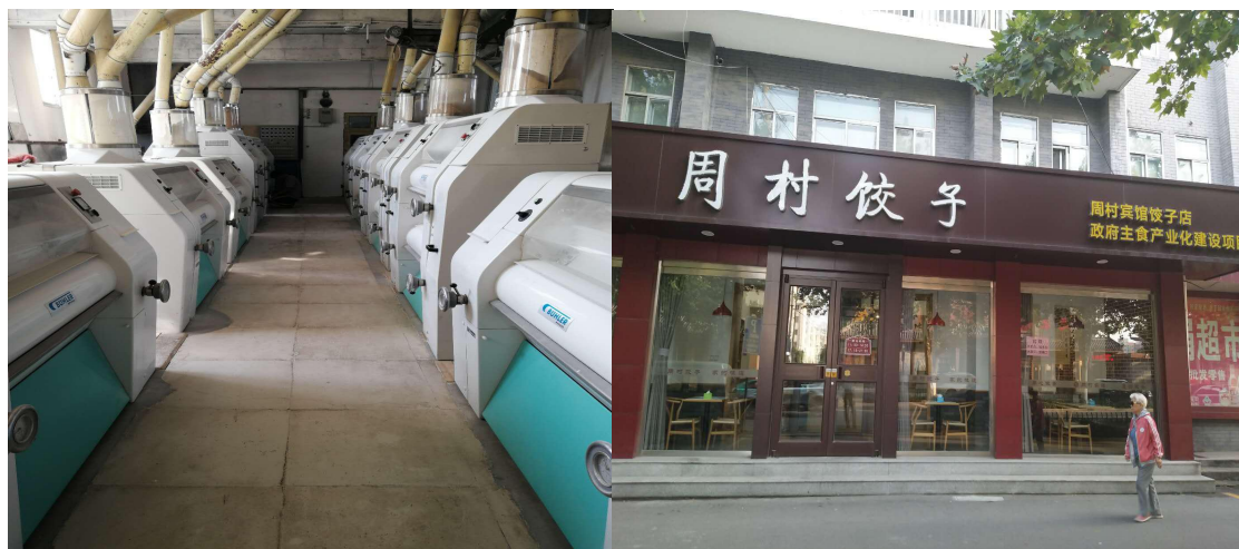
图3 山东东阿华云粮食制品有限公司磨粉机更换、 淄博周村宾馆有限公司项目建设图
